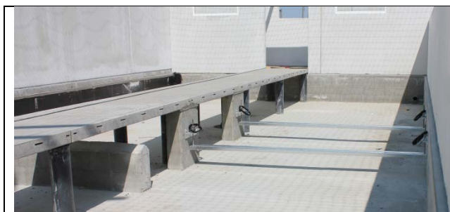
Figur 1. Vejeceller i gyllekanal før montering af gødningsopsamlingsbakke.
